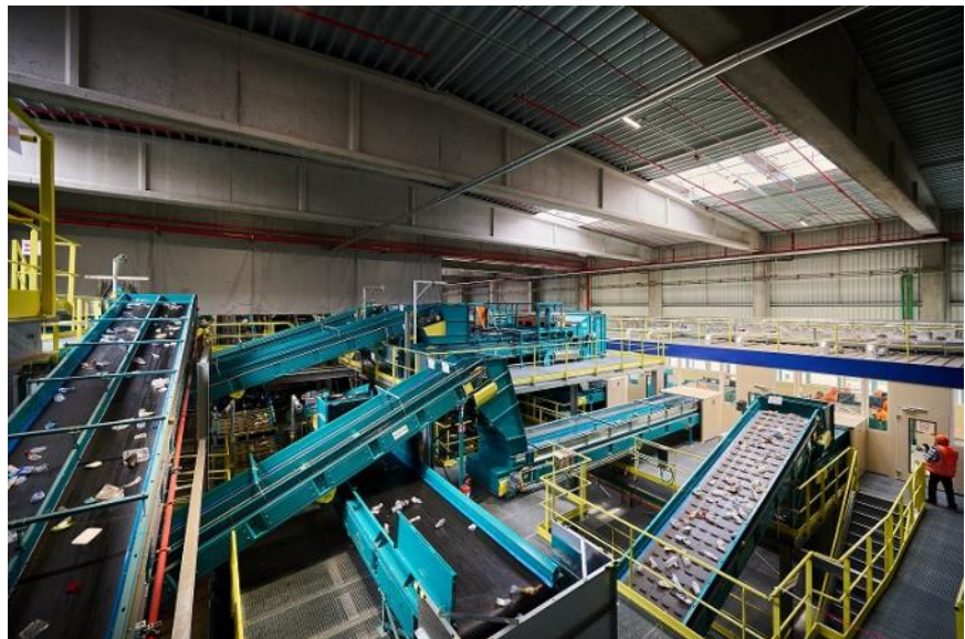
Centre de tri de Wallonie pour les emballages PMC - VAL'UP Sorteectentrum in Wallonië voor PMD-verpakkingen - VAL'UP
